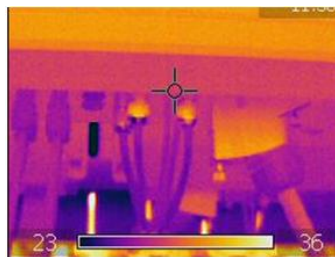
Figuur 37: opwarming van de kabelansluitingen in de omvormer
